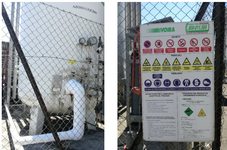
Figura 1 – Serbatoio esterno per azoto liquido (sinistra) e segnaletica di sicurezza (destra)
