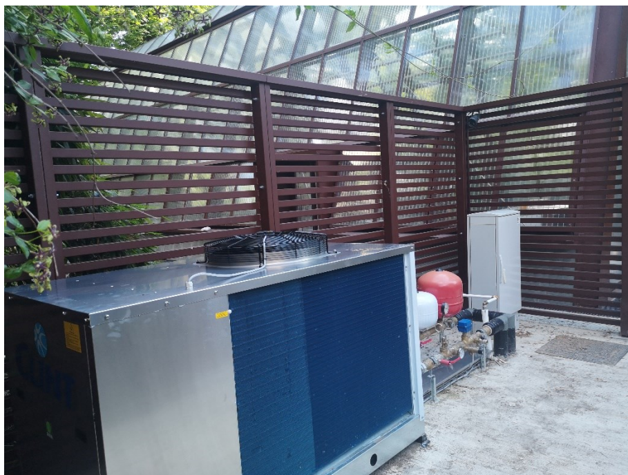
Impianto pompa di calore
