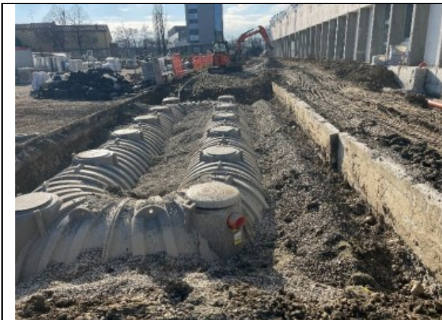
Cisterne interrate raccolta acqua piovana – Plesso ingegneria Ampliamento Campus Parco Area Scienze
